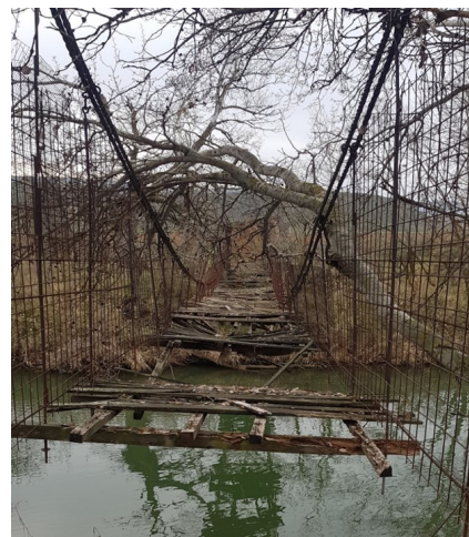
El puente en la actualidad, amenazada su estabilidad por un árbol caído.
